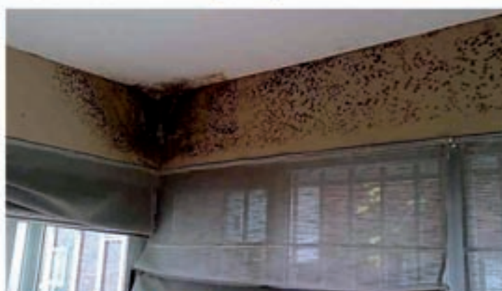
Problemas de humedad por condensación
