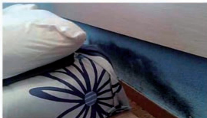
Problemas de humedad por capilaridad
