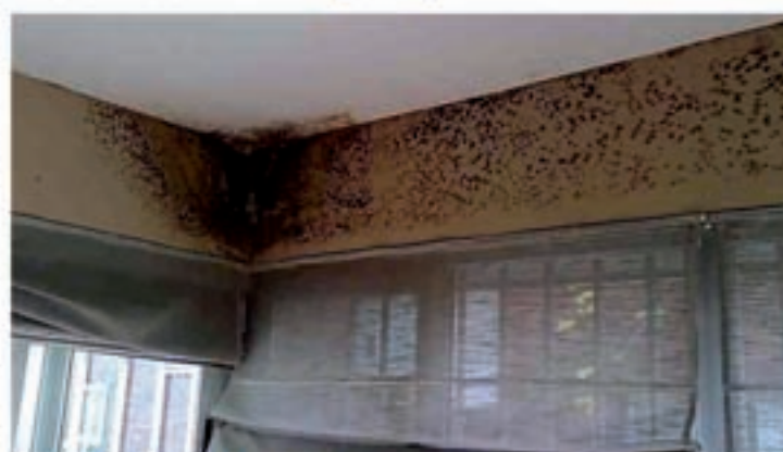
Problemas de humedad por condensación
