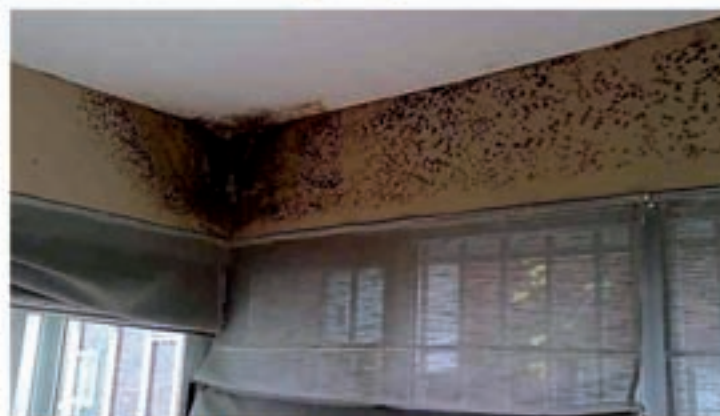
Problemas de humedad por condensación
