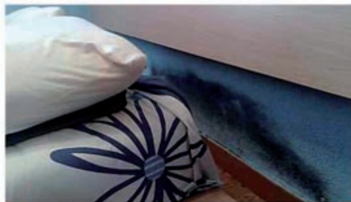
Problemas de humedad por capilaridad
