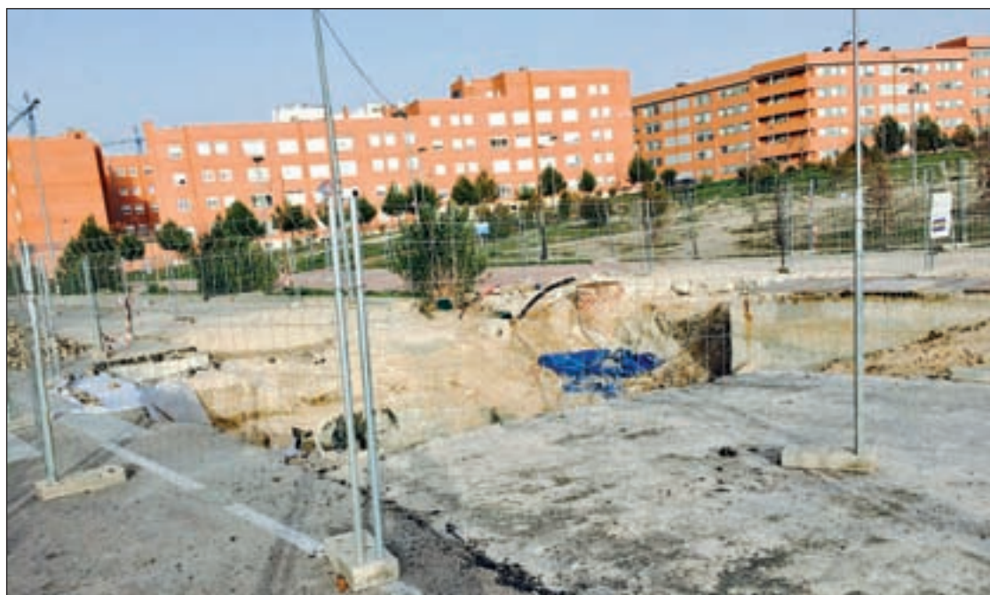
Estado actual de la zona afectada por el hundimiento del terreno LUCA JIMÉNEZ
