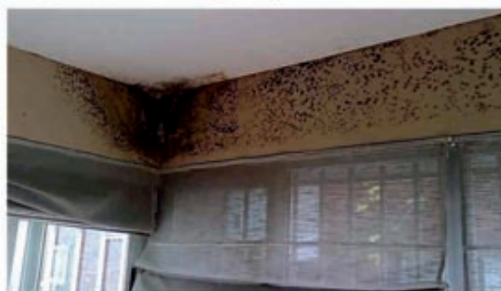
Problemas de humedad por condensación
