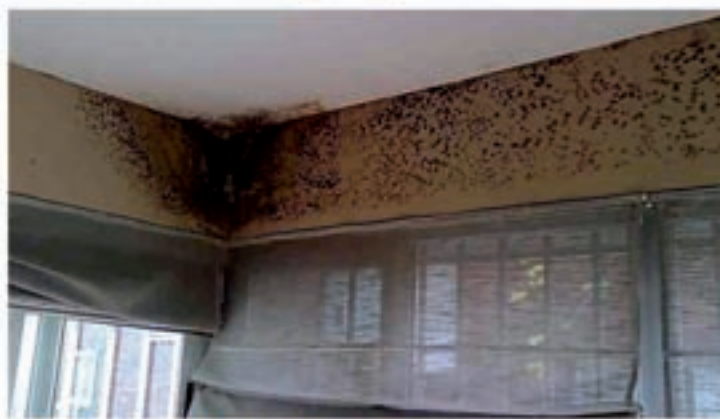
Problemas de humedad por condensación
