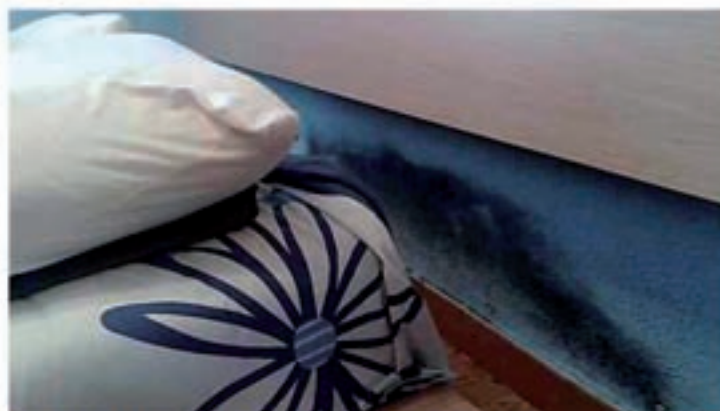
Problemas de humedad por capilaridad
