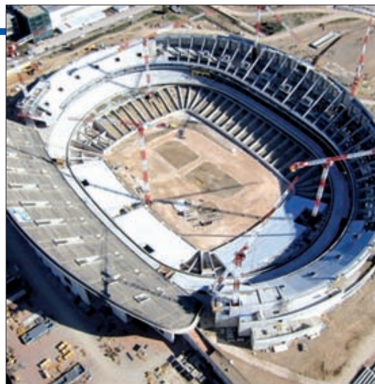
Estado de las obras de La Peineta, el pasado mes de marzo
