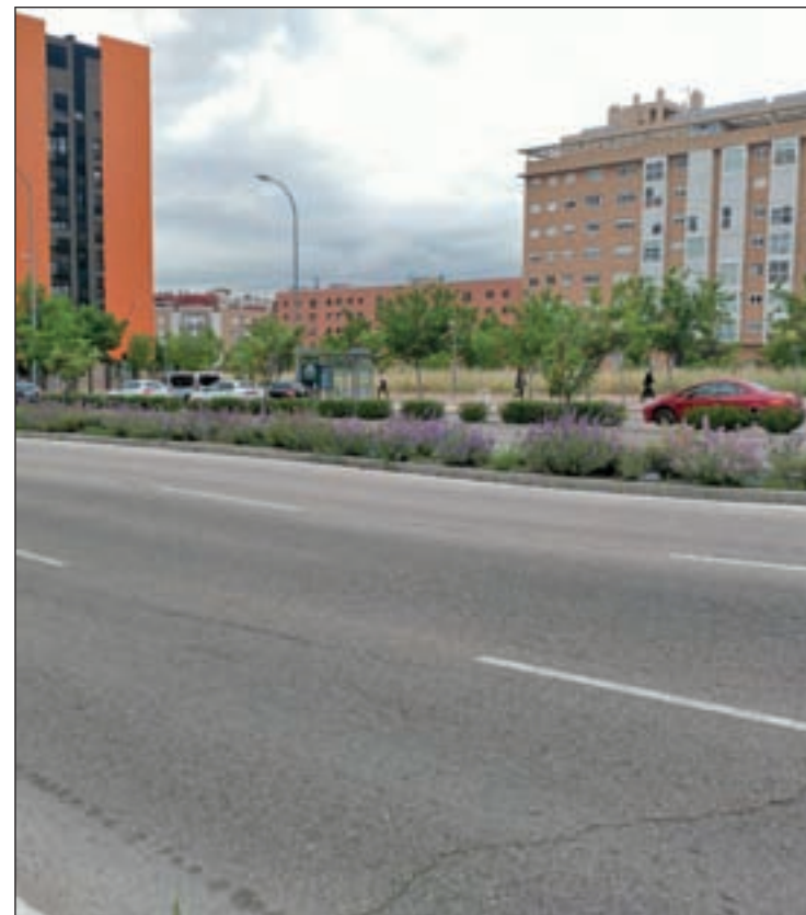
El estado irregular de la calzada en el 42 de avenida del Ensanche
