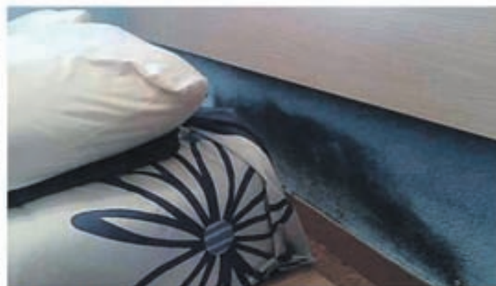
Problemas de humedad por capilaridad
