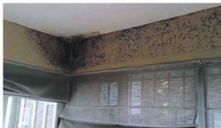
Problemas de humedad por condensación
