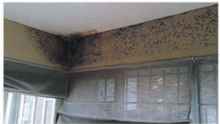
Problemas de humedad por condensación
