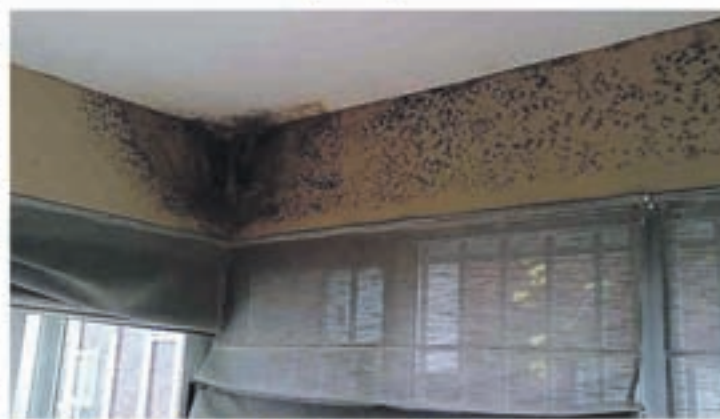
Problemas de humedad por condensación
