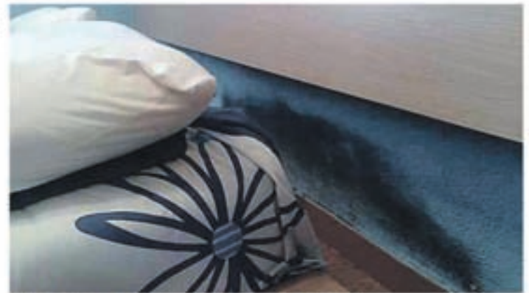
Problemas de humedad por capilaridad
