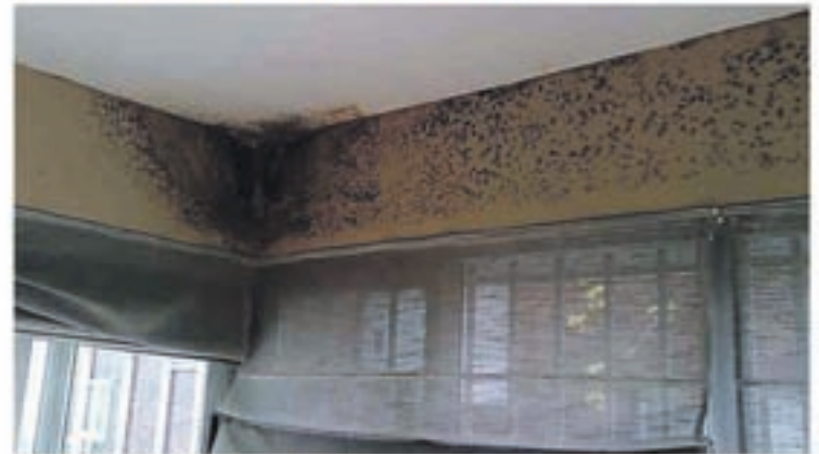
Problemas de humedad por condensación
