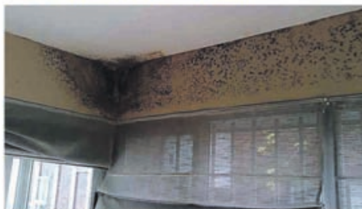
Problemas de humedad por condensación
