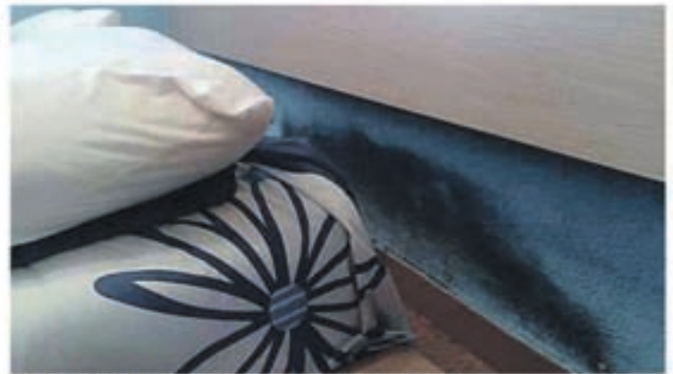
Problemas de humedad por capilaridad
