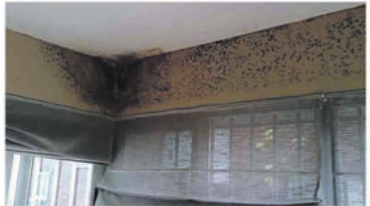
Problemas de humedad por condensación
