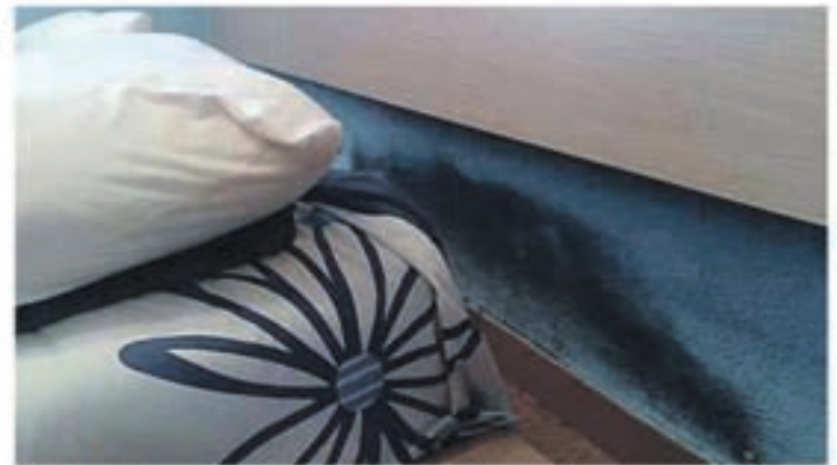
Problemas de humedad por capilaridad
