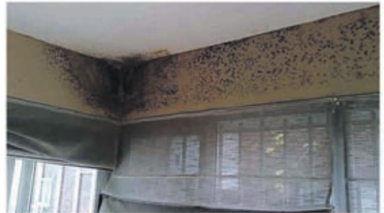
Problemas de humedad por condensación
