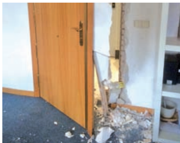
Destrozos en la puerta de la sede del PP local
