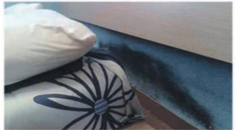
Problemas de humedad por capilaridad
