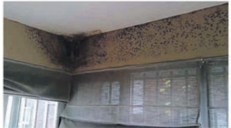
Problemas de humedad por condensación
