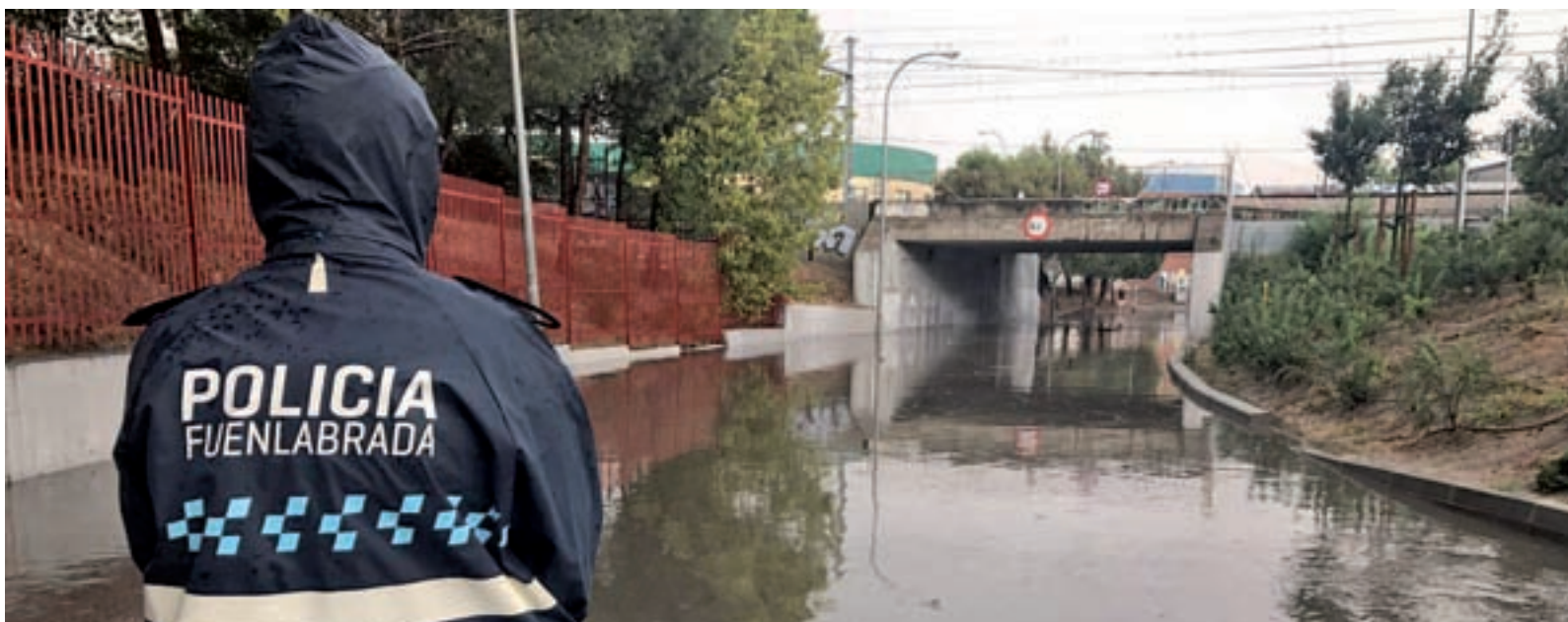
Puente anegado tras las lluvias
