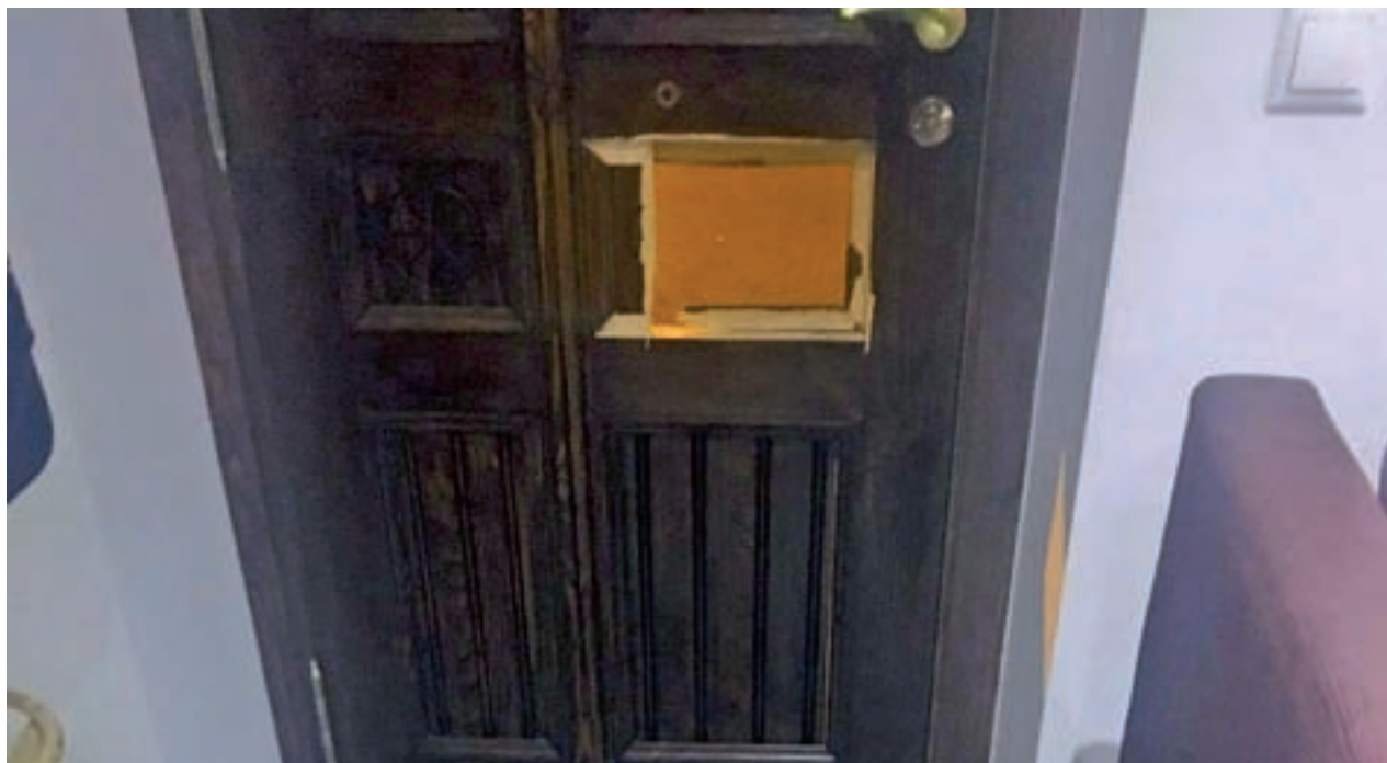
Estado de la puerta tras el intento de allanamiento de morada
