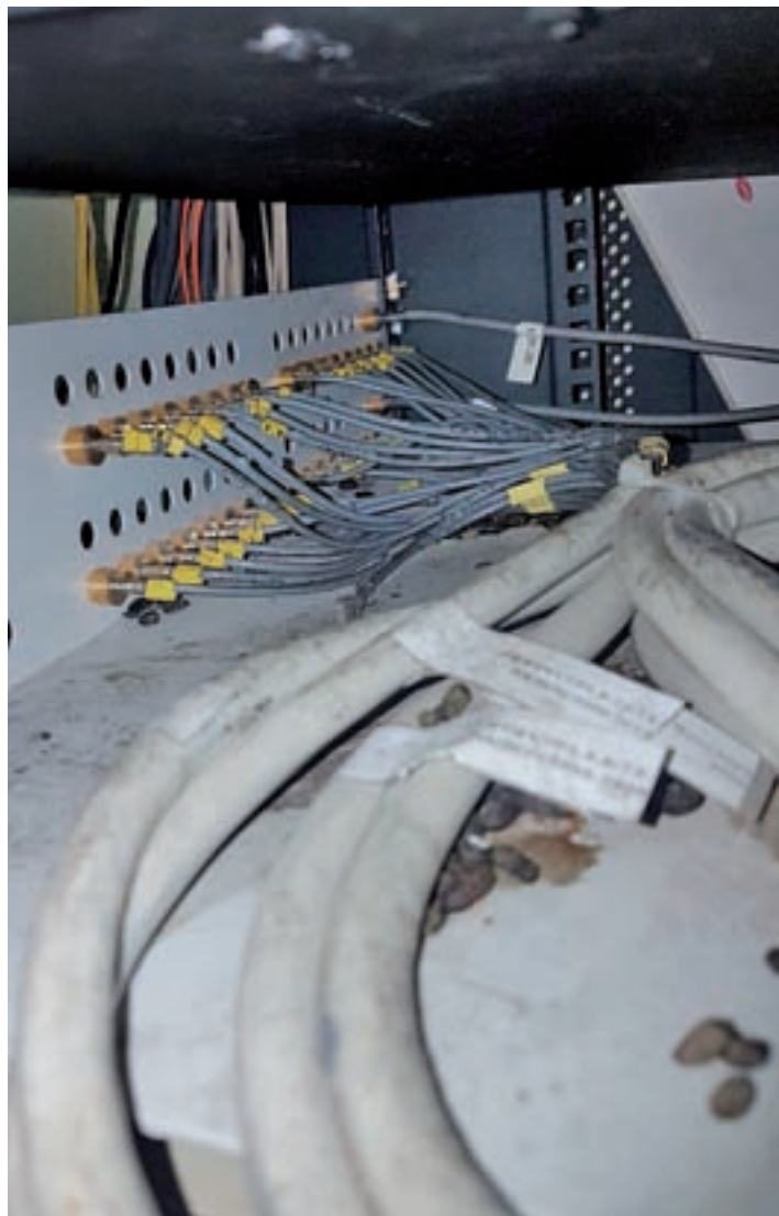
Estado de los cables CSIT UNIÓN POLICIAL
