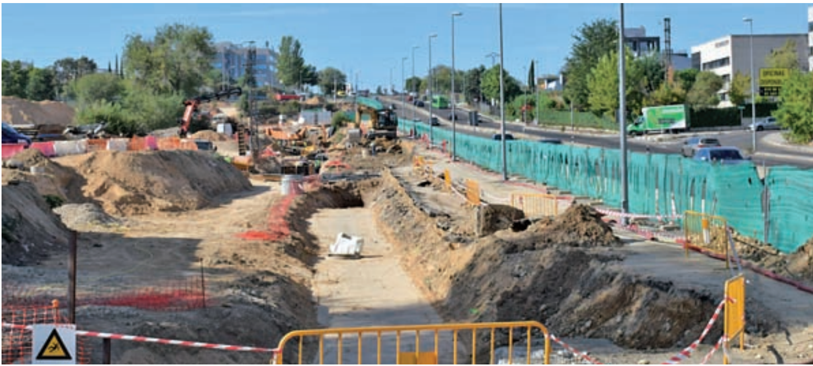
Las obras de urbanización que se están realizando en el ámbito de Los Peñotes CHEMA MARTÍNEZ / GENTE
