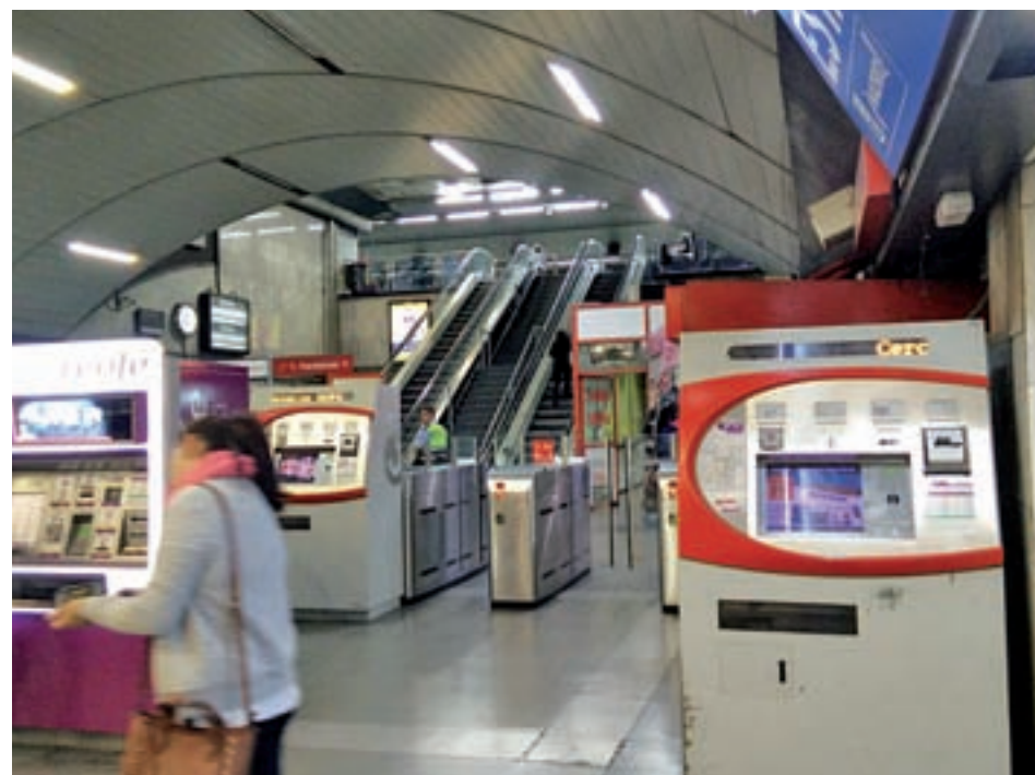
Escaleras mecánicas paradas en Méndez Álvaro A.D./GENTE
