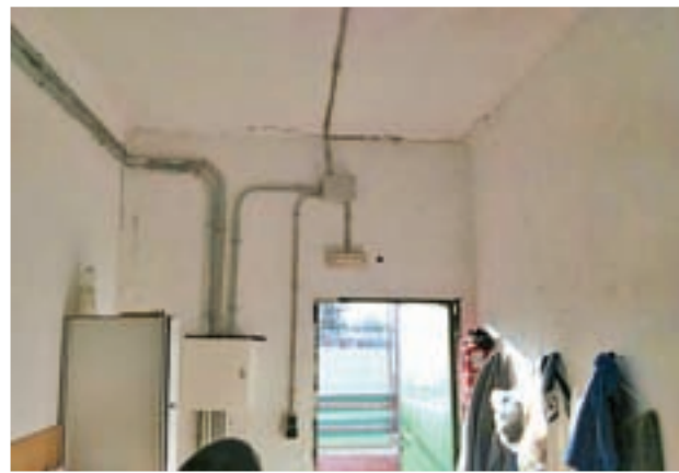
Estado de las paredes de los vestuarios
