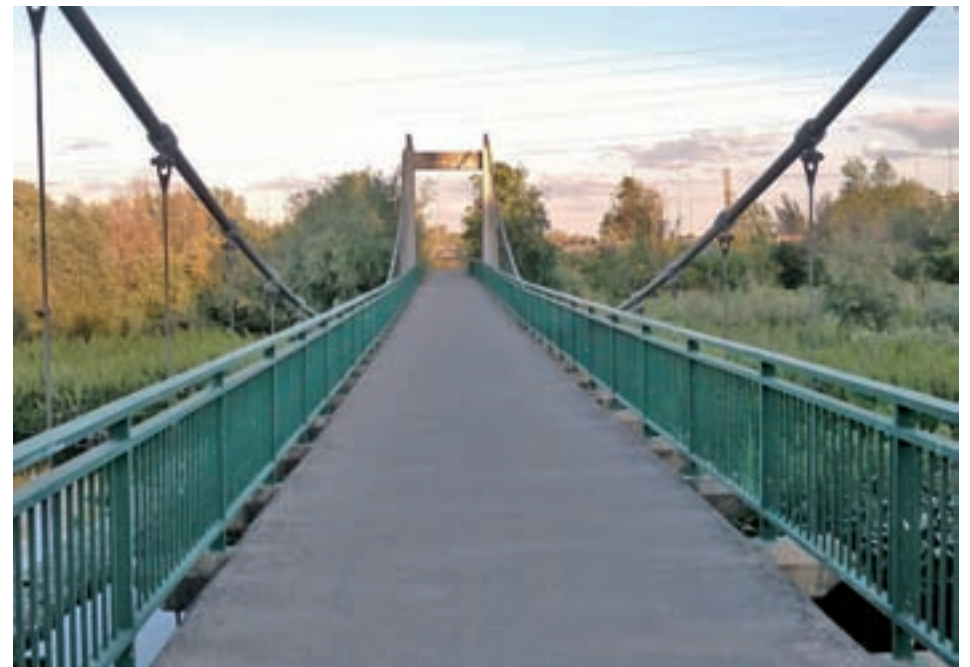
El puente ha estado cortado desde mayo
