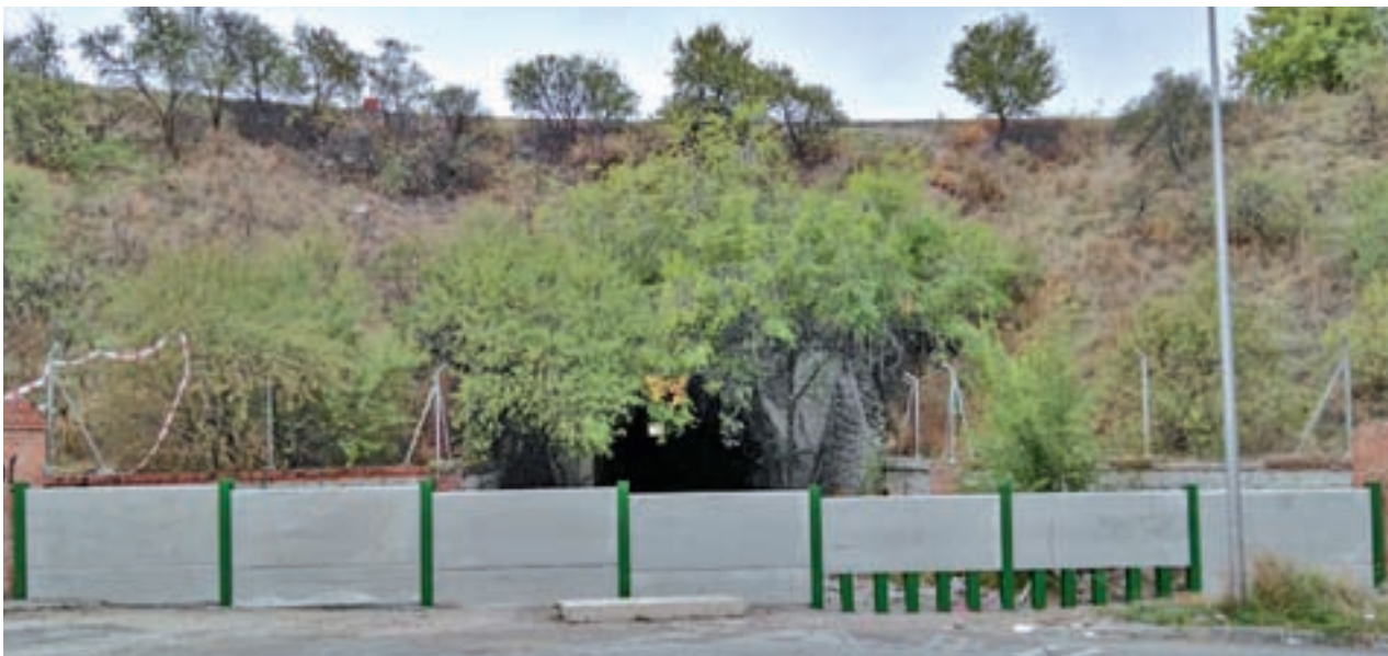
Las vallas impiden el acceso al paso subterráneo que discurre bajo las vías del tren
