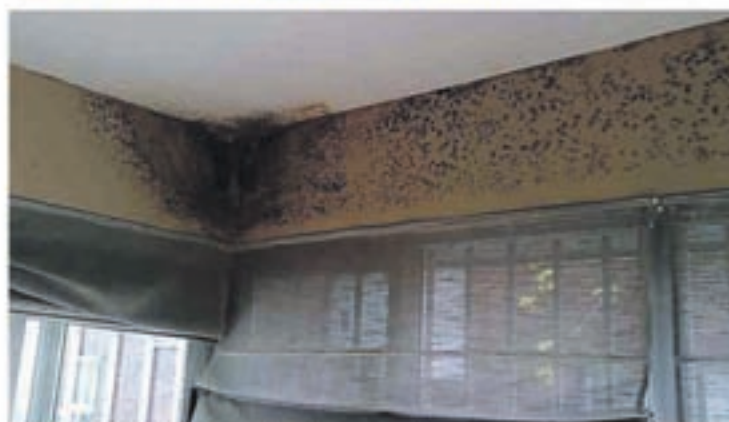
Problemas de humedad por condensación
