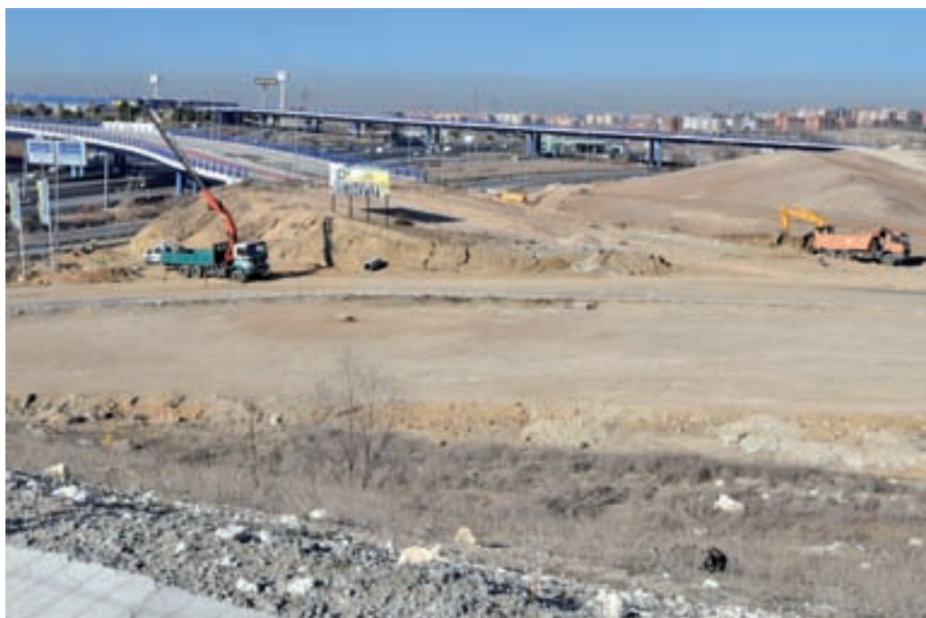
Las obras continúan en los terrenos del futuro barrio CHEMA MARTÍNEZ/ GENTE
