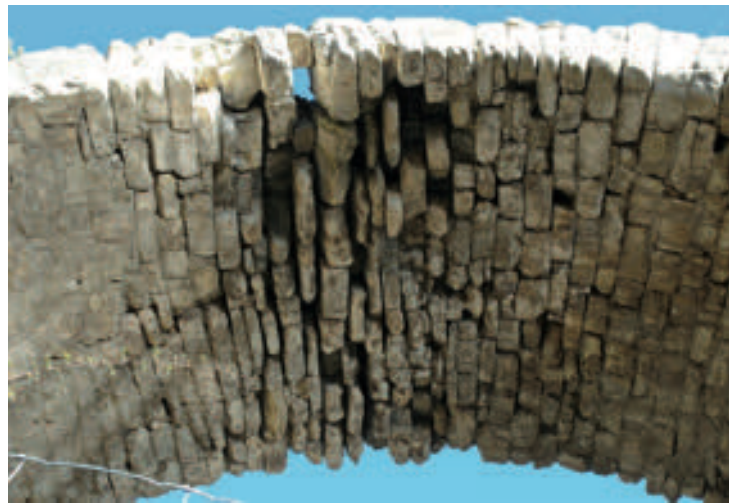
Estado actual de uno de los arcos del Puente Mantible.
