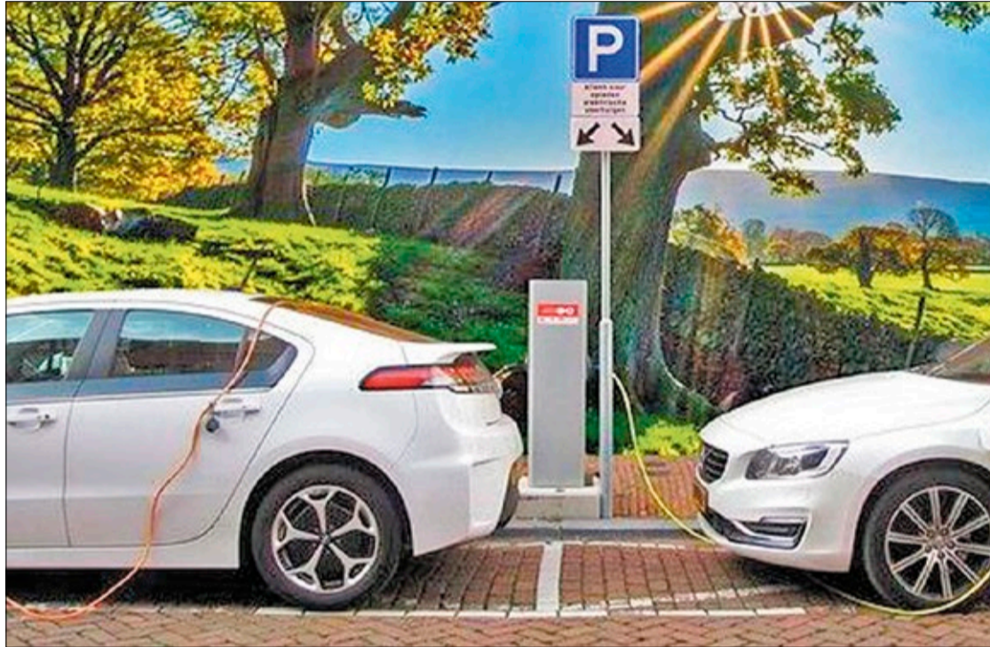
El Ayuntamiento de Santa María del Páramo instalará un punto de recarga para vehículos eléctricos para dos plazas y carga semi-rápida.
