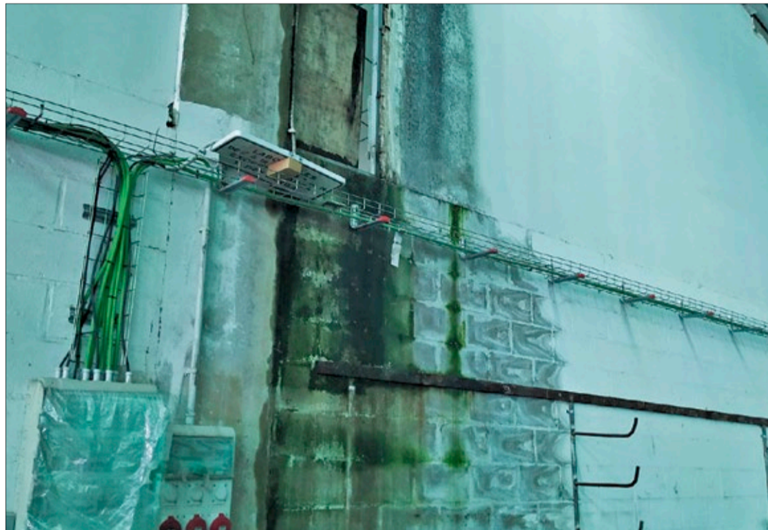
Estado que presentan las paredes de los Almacenes Municipales y que ha denunciado el Grupo Municipal del Partido Popular.
