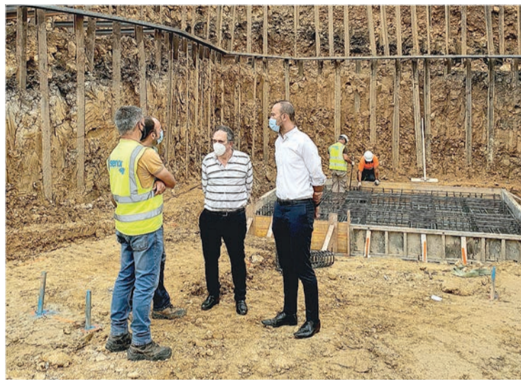
El alcalde y el concejal de Obras, durante su visita a las obras.
