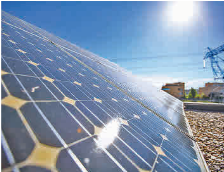
Placas solares en los tejados de Las Rozas
