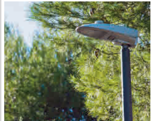
Una de las nuevas luminarias
