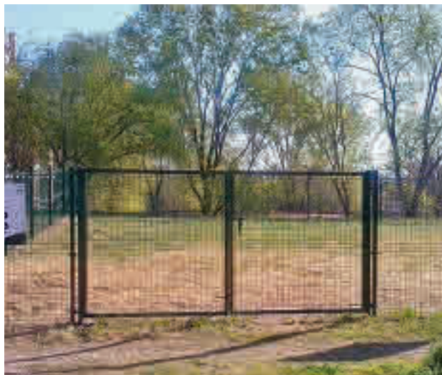
Área de recreo canino: En la avenida de Berlín han terminado las obras para la creación de un área de recreo canino. Los trabajos han consistido en la instalación de 140 metros de cerramiento, además de papeleras para depositar las bolsas con excrementos.
