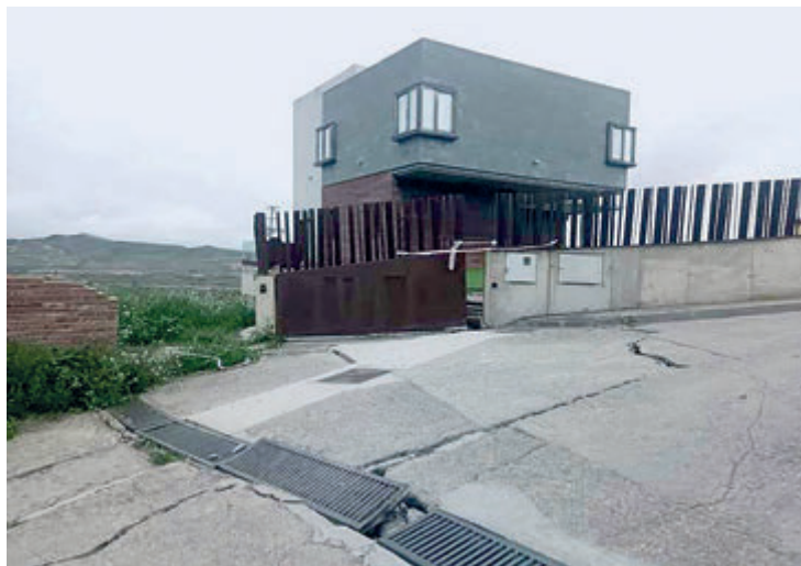
Los desperfectos en la ladera de Autol.
