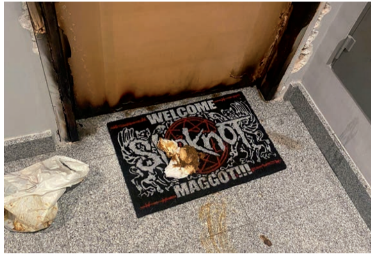
El estado en el que queda la casa de la víctima.
