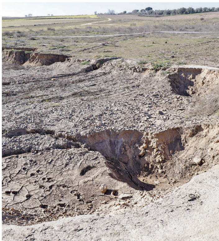
Algunas de las grietas que han aparecido
