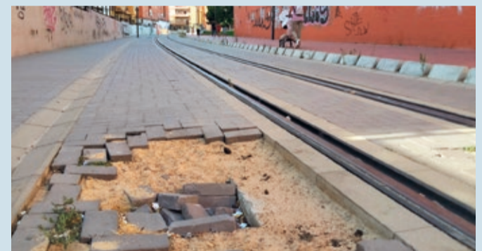
Estado de la vía de Feve en el centro de la capital leonesa.
