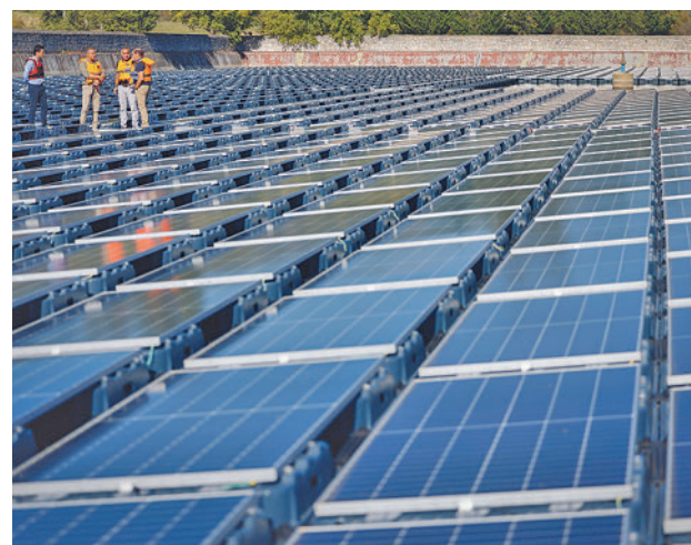
Instalación fotovoltaica de Torrelaguna
